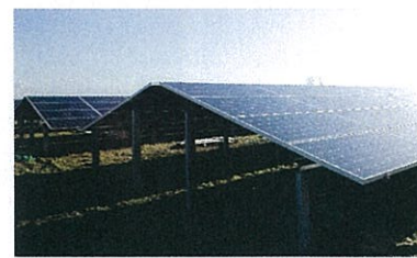
Mit Solarmodulen belegte Modultische auf Avantis 2 in Ost/West-Ausrichtung
