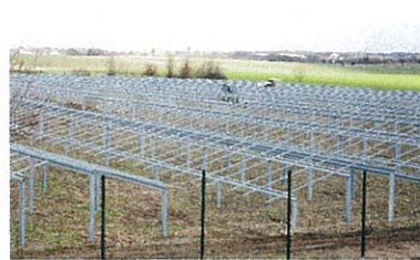
Der Beweis ist erbracht: Der Bau von planen Modultischen ohne Verstellelemente ist möglich
